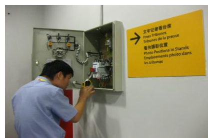
图 8 比赛场馆空调送风机控制箱巡检
