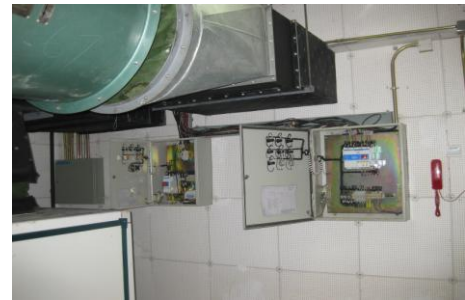
图 5 空调送风机控制箱
