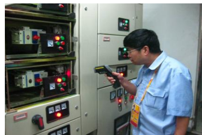
图 7 比赛场馆空调机组控制柜巡检
